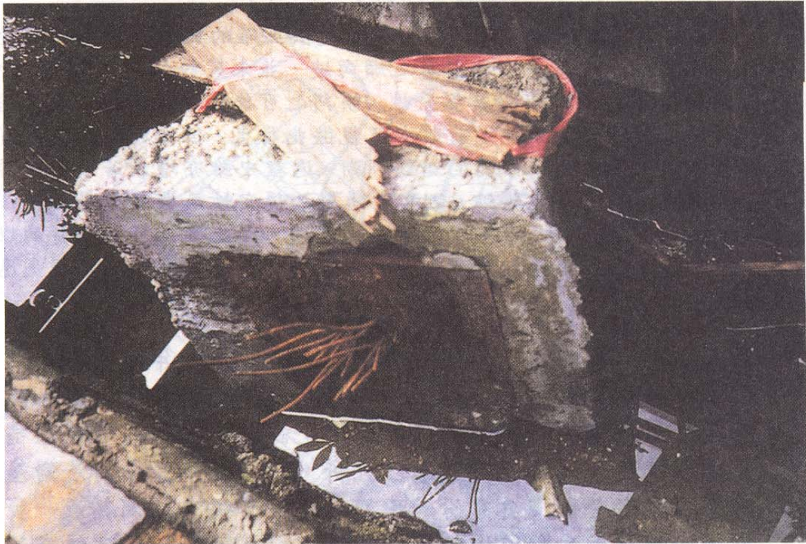
照片-3 破壞前一年該擋土牆已出現錨頭掉落之情形
