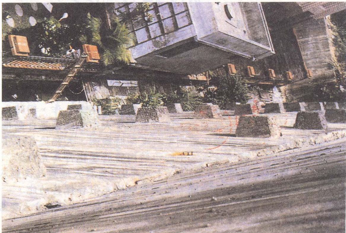
照片-4 錨頭掉落之情形(由上往下拍攝)
