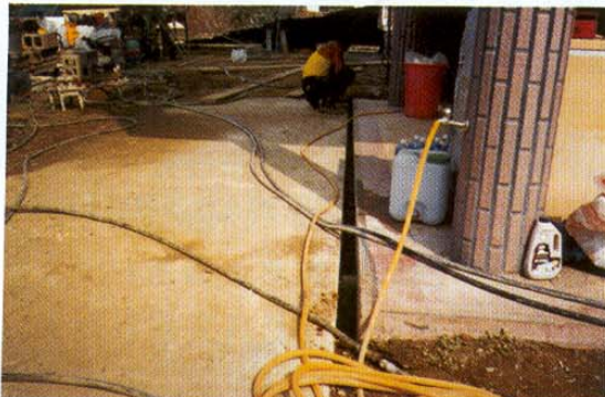
(a) 地上3F、筏式基礎之建築，扶正前最大下陷達50cm 傾角約1/37
