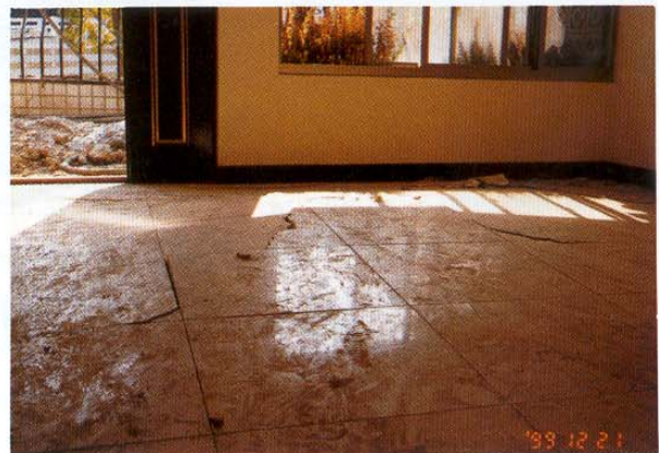
(f) 灌漿施工時造成鄰房地坪隆起
