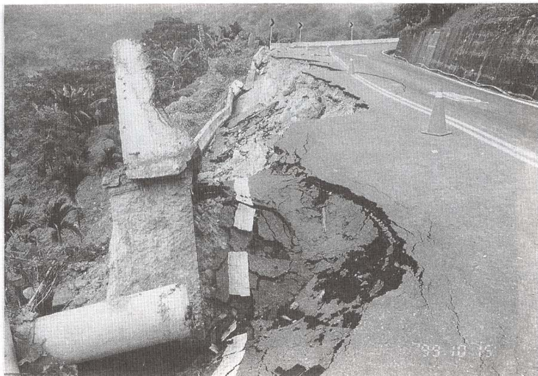
片-5 波高甚高採重力式擋土牆斷面明顯不足
