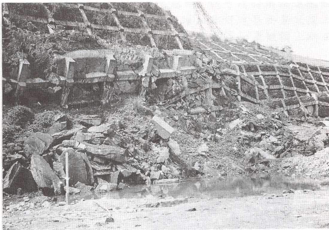
照片-4 邊坡地水豐富造成邊坡下滑
