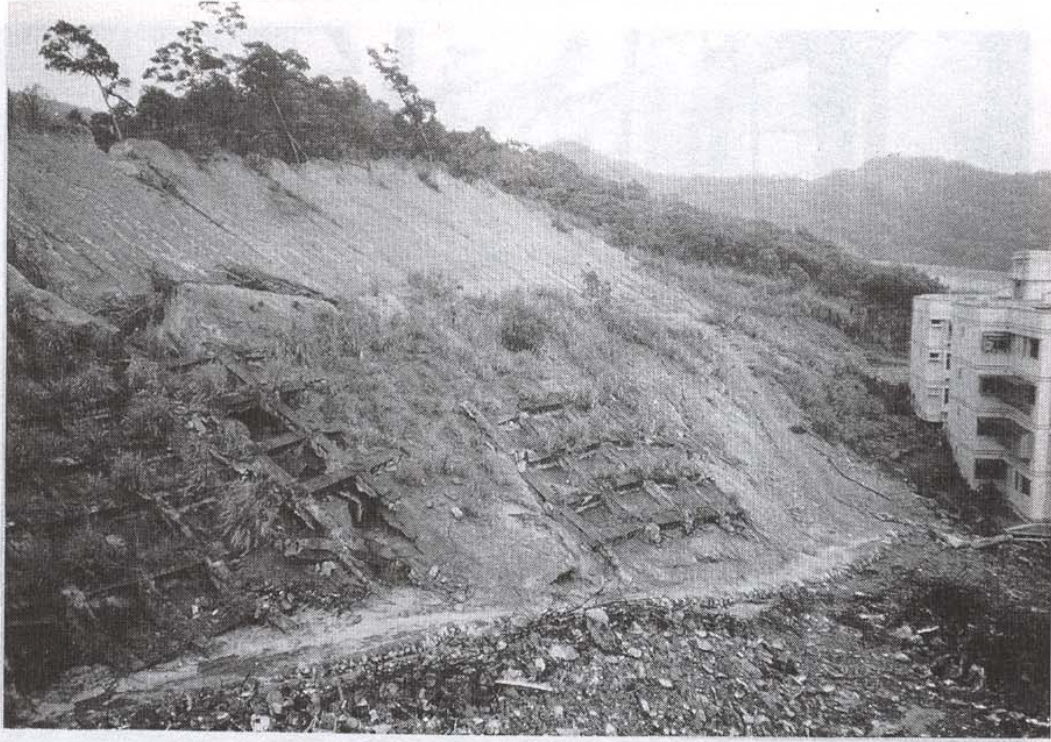
照片-1 邊坡順向坡平面破壞
