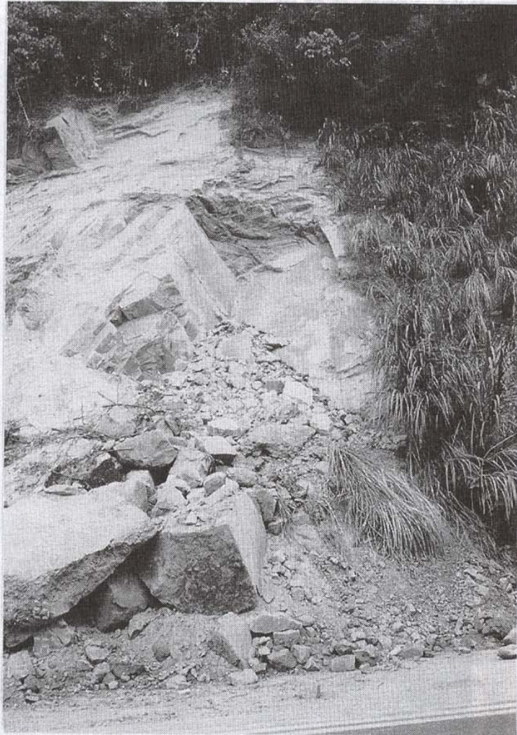
照片-2 邊坡楔型破壞
