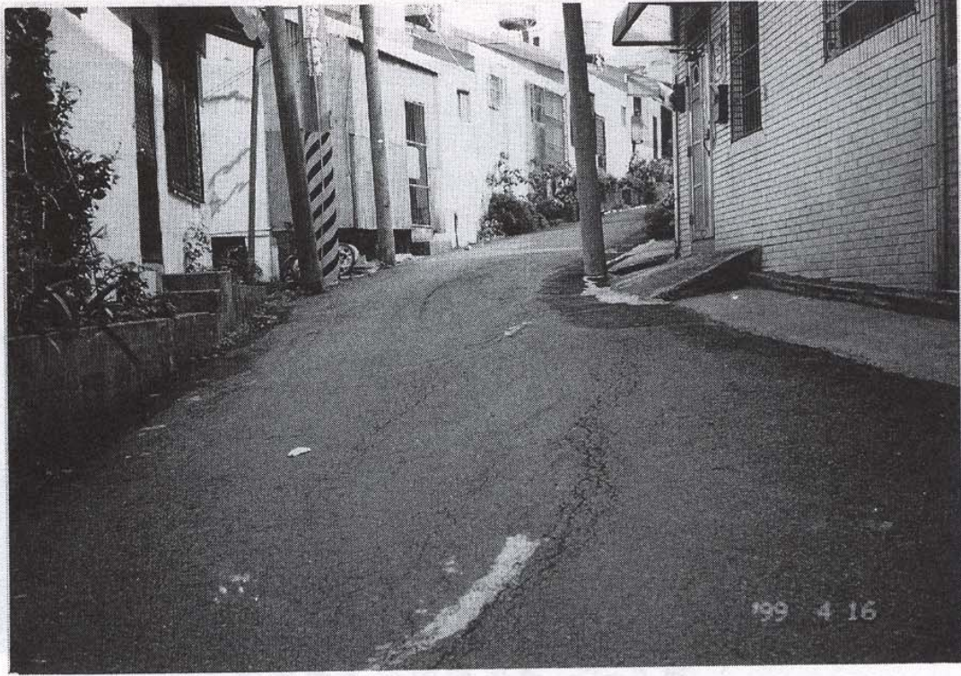
照片-3(a) 社區整體地層潛變破壞，電線桿呈傾斜現象
