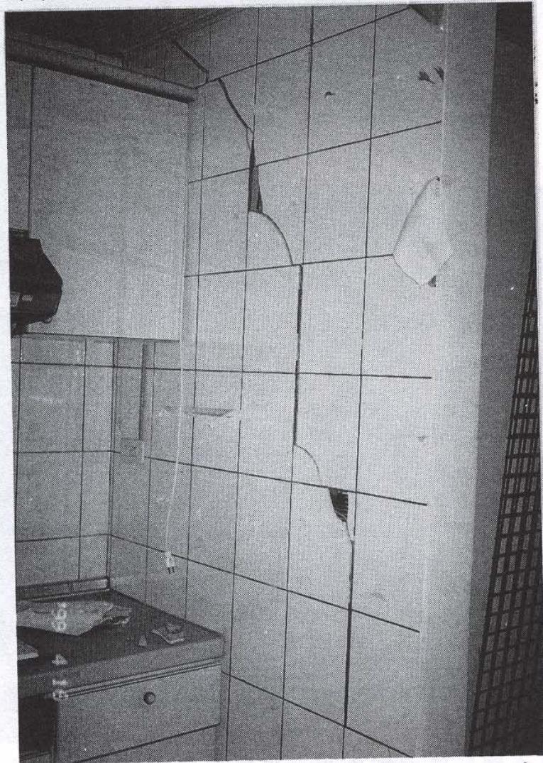
照片-3(b) 因潛變破壞建築物室內呈嚴重龜裂
